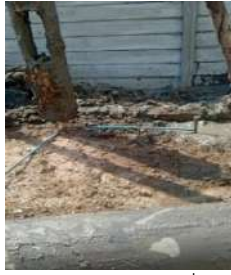
ภาพที่ 9 งานตรวจสอบศูนย์กลาง (Center) เพื่อตรวจ Line Offset แกน x,y
